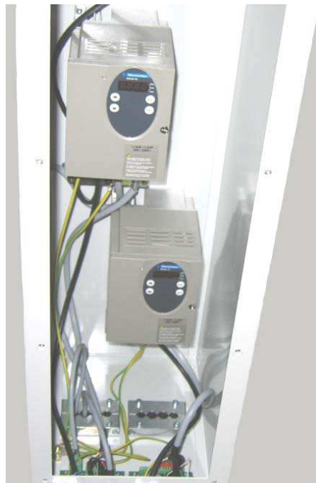
Przyłącza kabli i przemienniki częstotliwości w manipulatorze ZA
