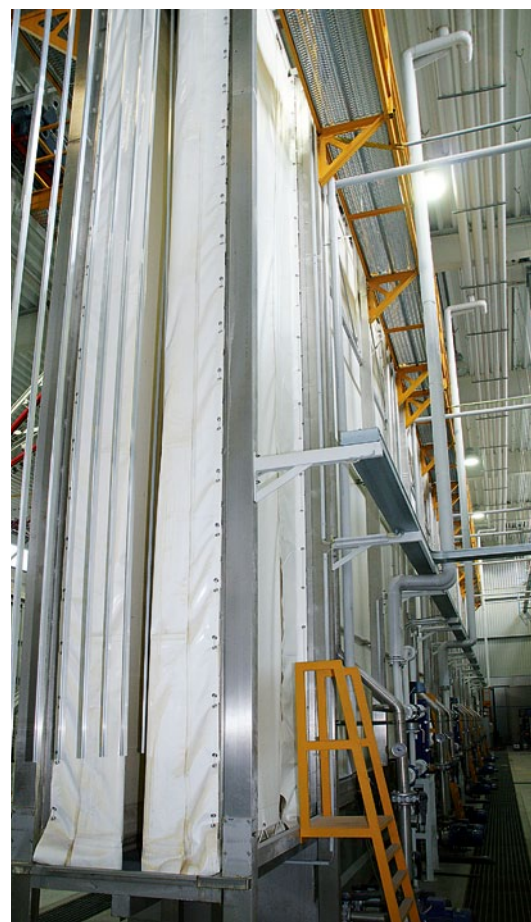
Tunel przygotowania powierzchni.
